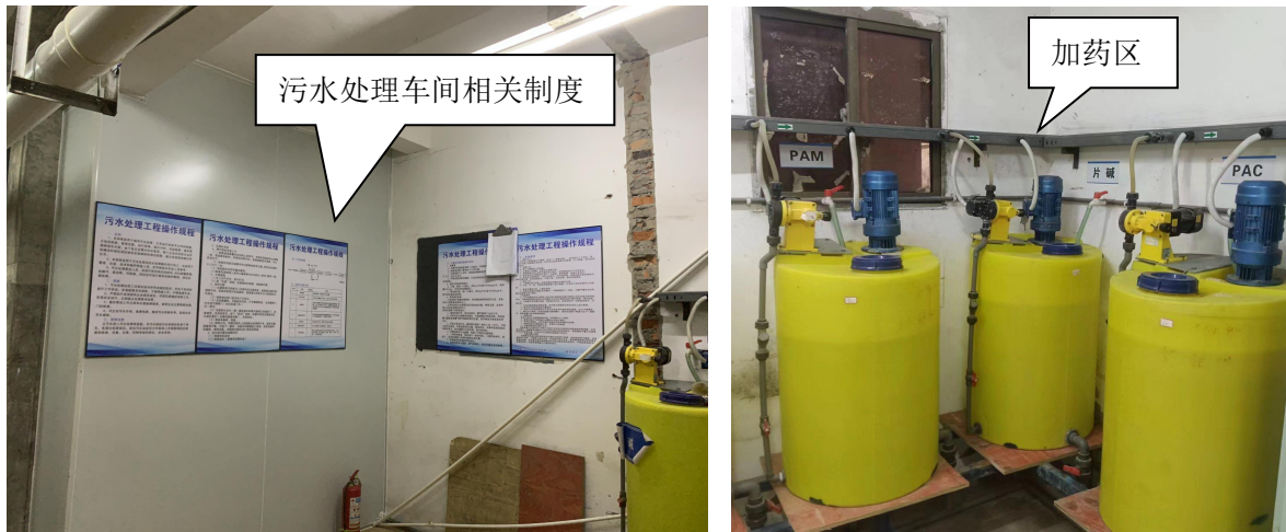
图 4-2 项目生产废水处理设施
