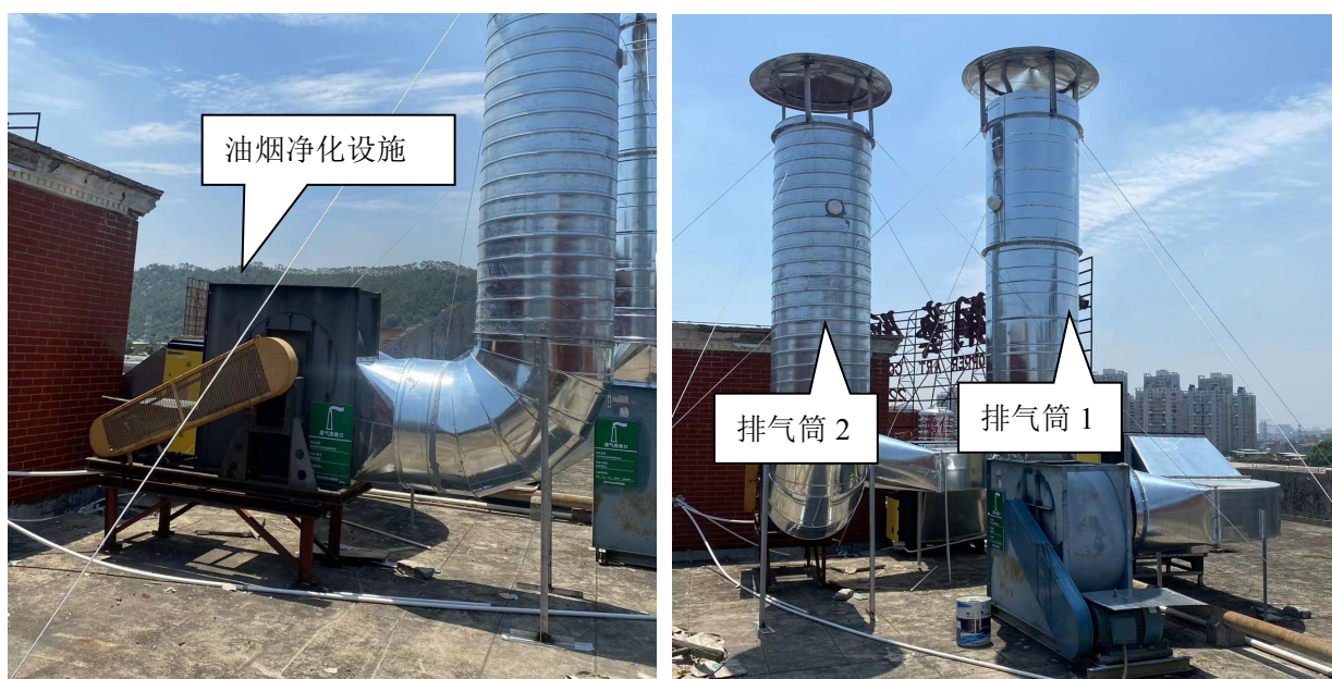
图 4-4 项目废气处理设施
